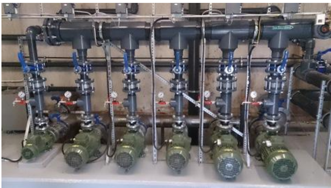
Foto 13. Pärnu-Jaagupi veetöötlusjaama sisevaade
