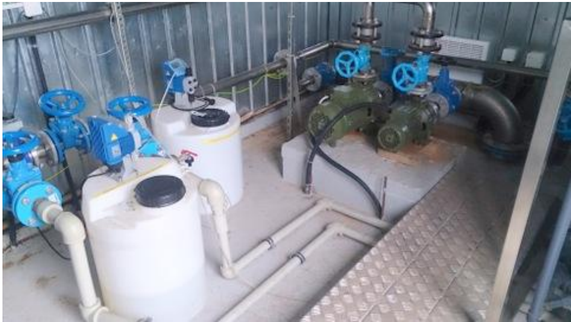
Foto 25. Vahenurme veetötlusjaama desinfitseerimisseadmed
