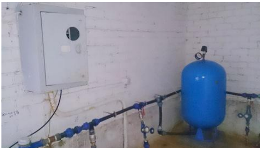
Foto 48. Kergu keskuse puurkaev-pumpla sisevaade
