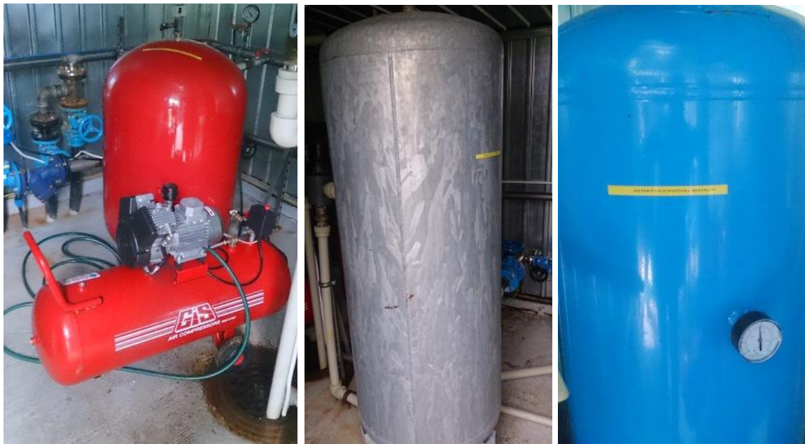
Fotod 27-29. Vahenurme küla puurkaev-pumpla (katastri number 6155): õhukompressor ja hüdrofoor, rauafilter, aeratsiooniõhu mahuti
