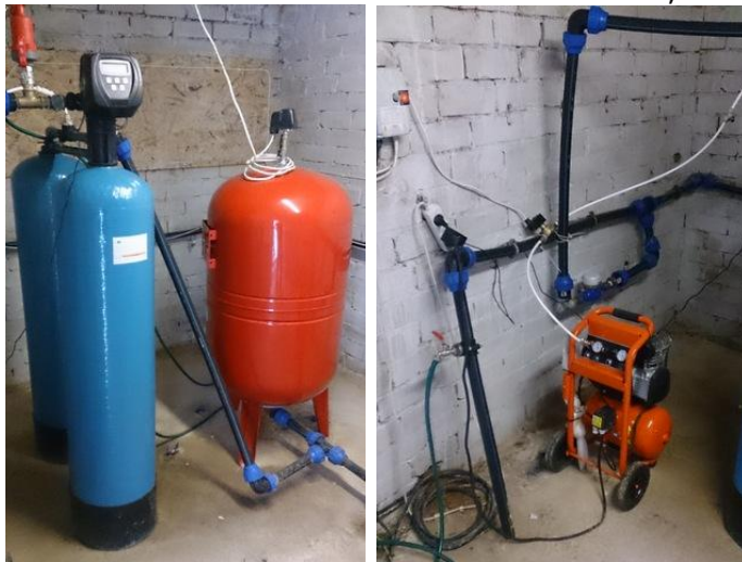
Foto 61. Võidula puurkaev-pumpla veetötlusseade, hüdrofoor ning kompressor
