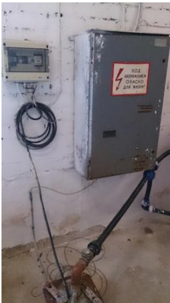
Foto 52. Kaisma puurkaev-pumpla sisevaade
