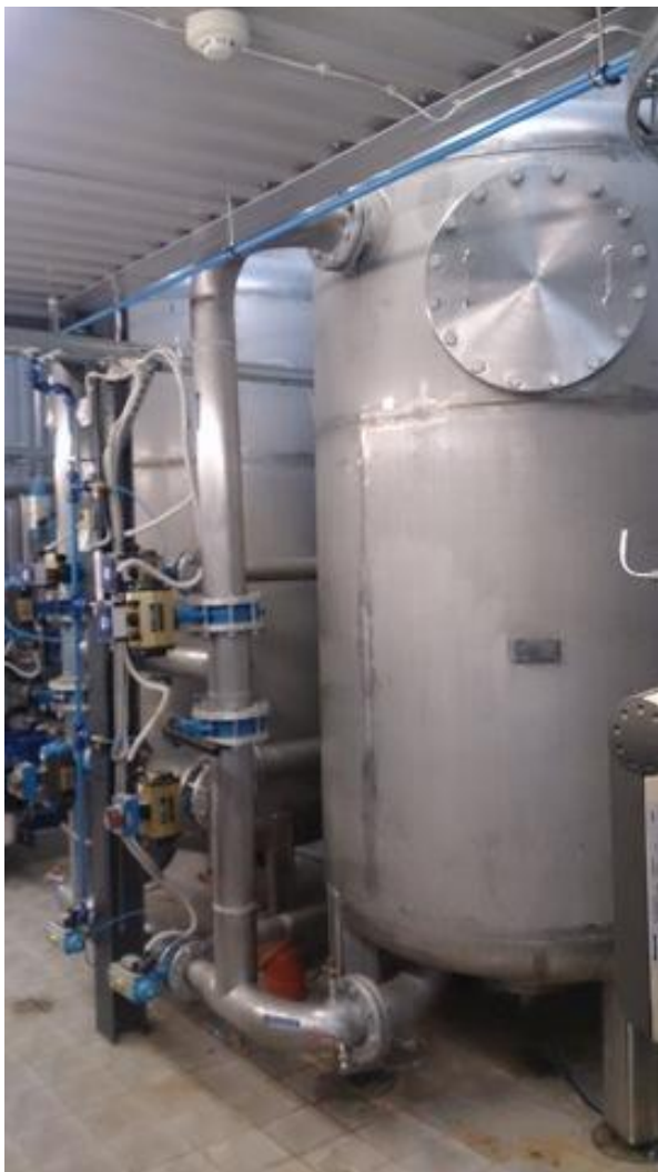
Foto 1. Veetöötlusjaama sisevaade I
