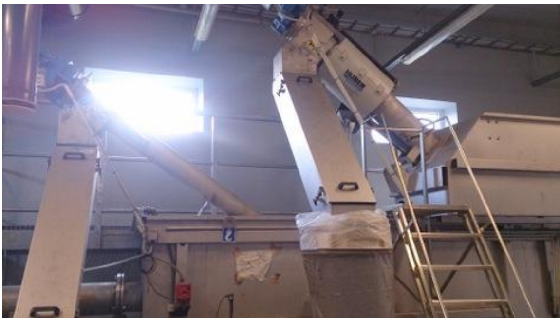
Foto 18. Pärnu-Jaagupi reoveepuhastihoone sisevaade II
