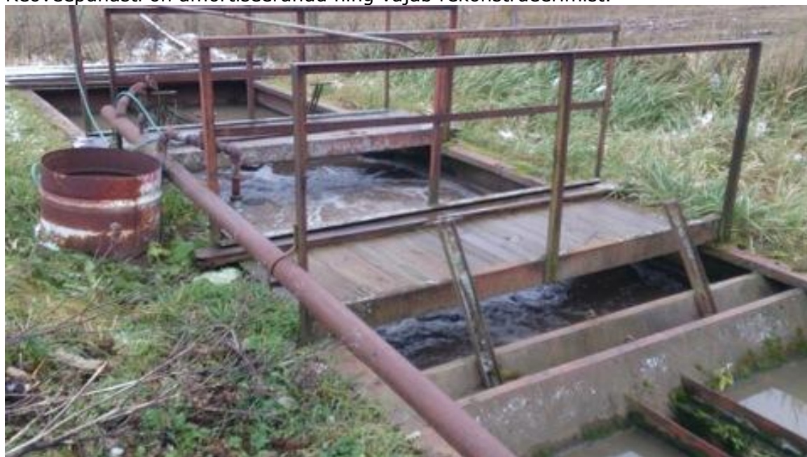
Foto 39. Pärnjõe küla reoveepuhasti aeratsioonimahuti
