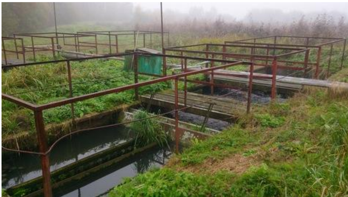
Foto 23. Libatse reoveepuhasti aeratsioonimahutid
