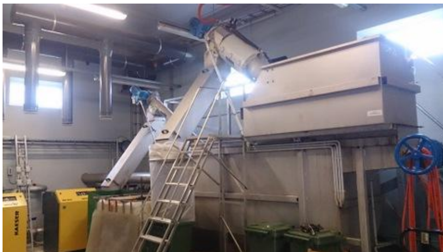
Foto 17. Pärnu-Jaagupi reoveepuhastihoone sisevaade I
