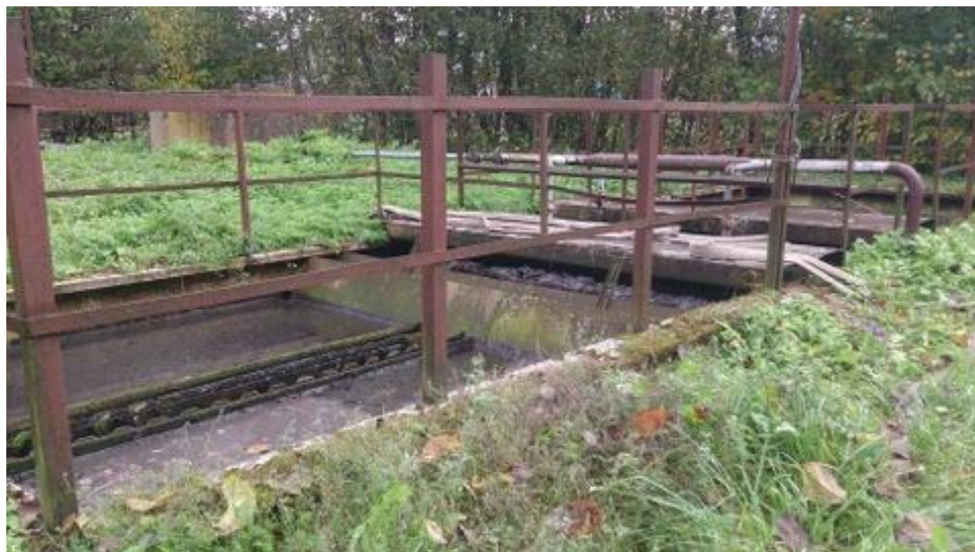
Foto 30. Vahenurme küla reoveepuhasti aeratsioonimahutid
