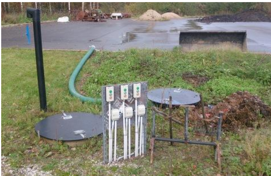
Foto 20. Purgimissõlm Pärnu-Jaagupi reoveepuhasti juures
