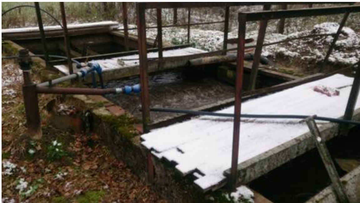
Foto 42. Suurejõe reoveepuhasti aeratsioonimahuti
