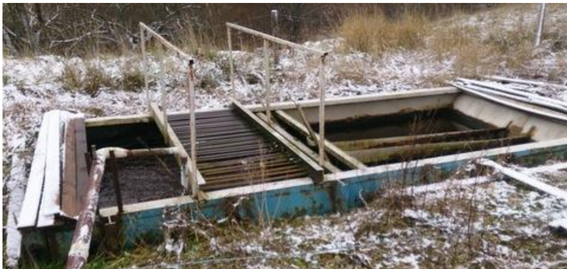
Foto 55. Kaansoo küla reoveepuhasti aeratsioonimahuti
