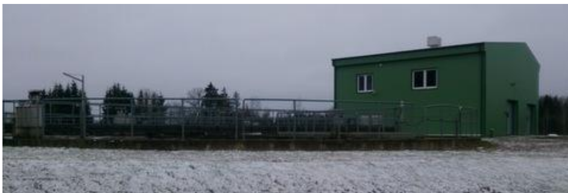
Foto 4. Vändra reoveepuhasti tehnohoone ja aeratsioonitangid
